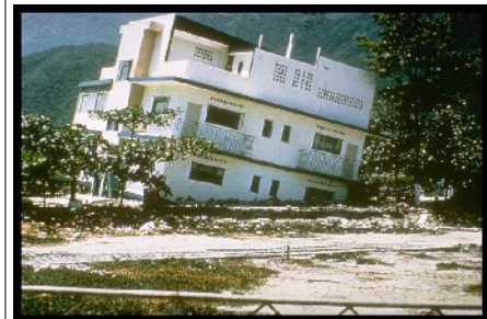
Liquéfaction des sols suite au séisme de Caracas (Vénézuéla) en 1967 (Source USGS)
