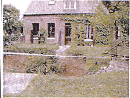
Conséquence d'un affaissement (Somme) – (Source : BRGM)
